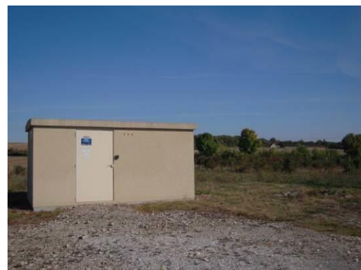
Photographie 7. Poste de livraison (source : Enertrag)
