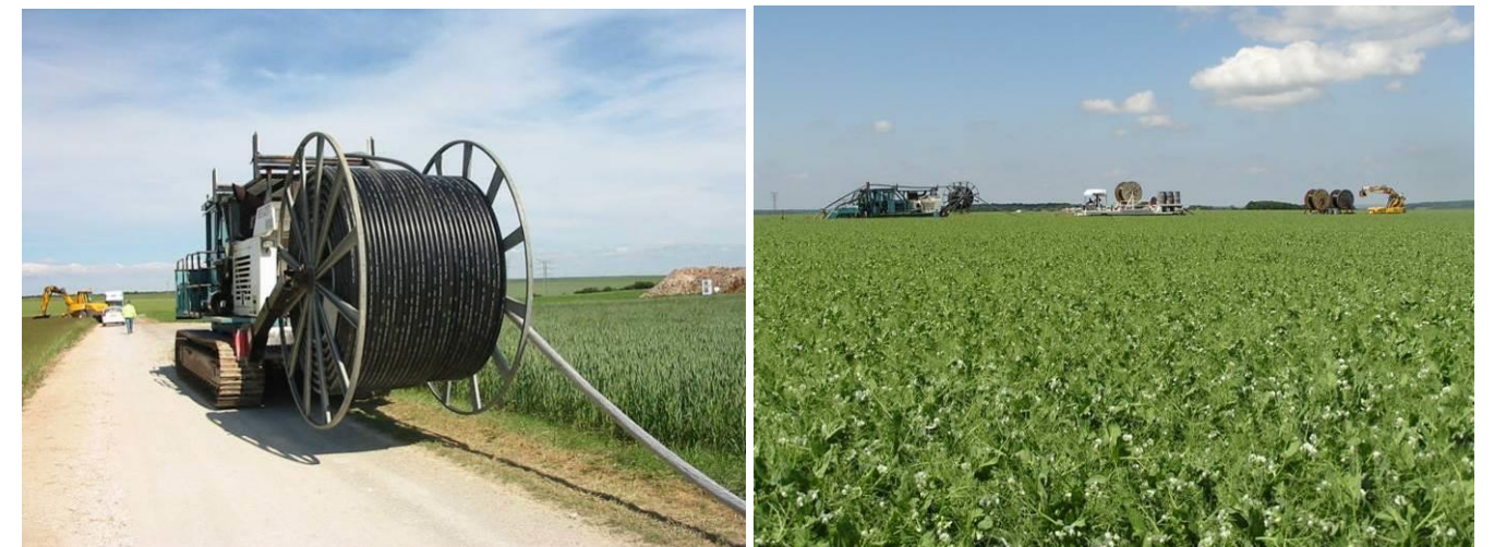
Photographie 8. Raccordement au réseau électrique (source : Enertrag)
